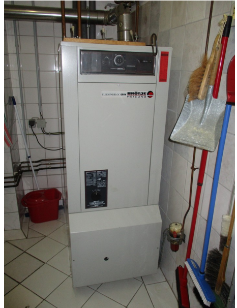
Foto: aktuelle Heizanlage
