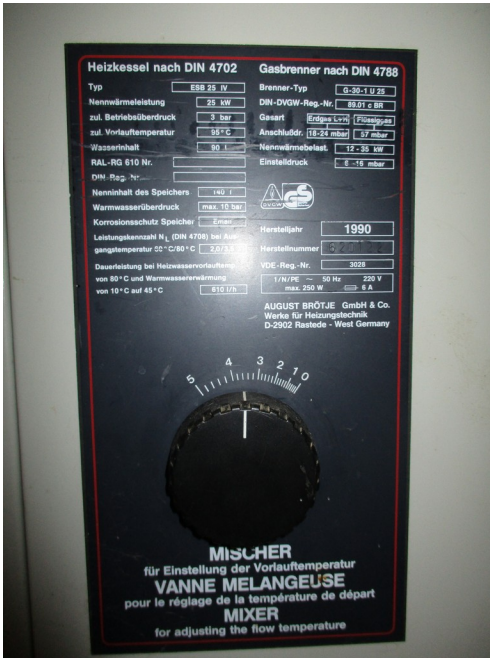
Foto: aktuelle Heizanlage
